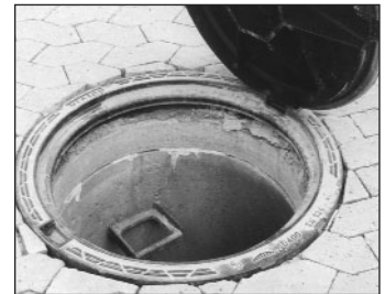
Abbildung 2: Nicht vollflächig vermörtelter Auflagerring und fehlerhafter Einbau einer Schachtabdeckung innerhalb einer Verbundsteinpflasterfläche
